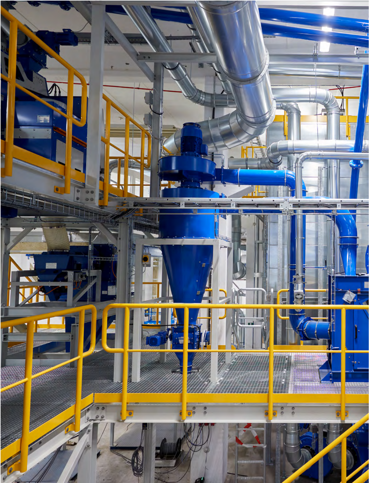
Stena Recycling öppnade en storskallig återvinningsanläggning för batterier år 2023. Foto: Stena Recycling
